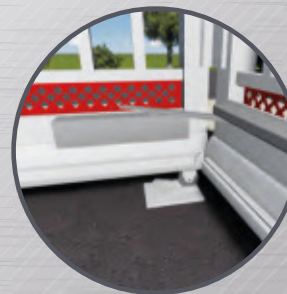
Türschließer und Bodeneinlauf
